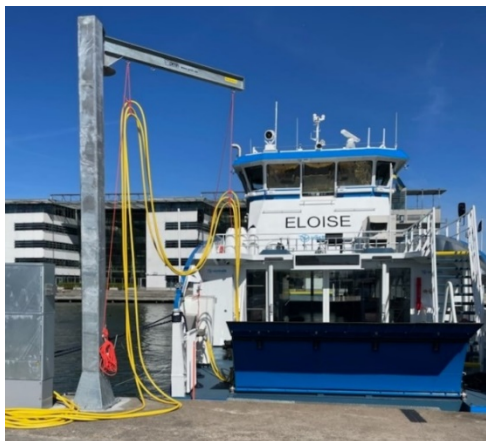
Figur 8: Ny laddstation för Eloise med kapacitet av 3 x 125 A
