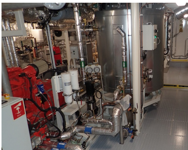
Figur 4: Eloise maskinrum med värmeackumulatortanken till höger
